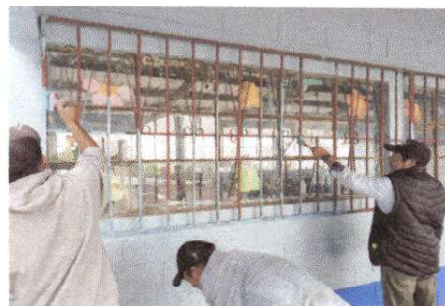
Foto 6: Pintadas de balcones
