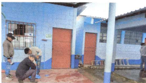
Foto 5: Pintadas de puertas
